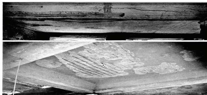
Rys. 1. Odpryski na elementach żelbetonowych w piwnicach Budynku Akademii Nauk powstałe w trakcie pożaru i w czasie trzęsienia ziemi w San Francisco, 1906 (7)
